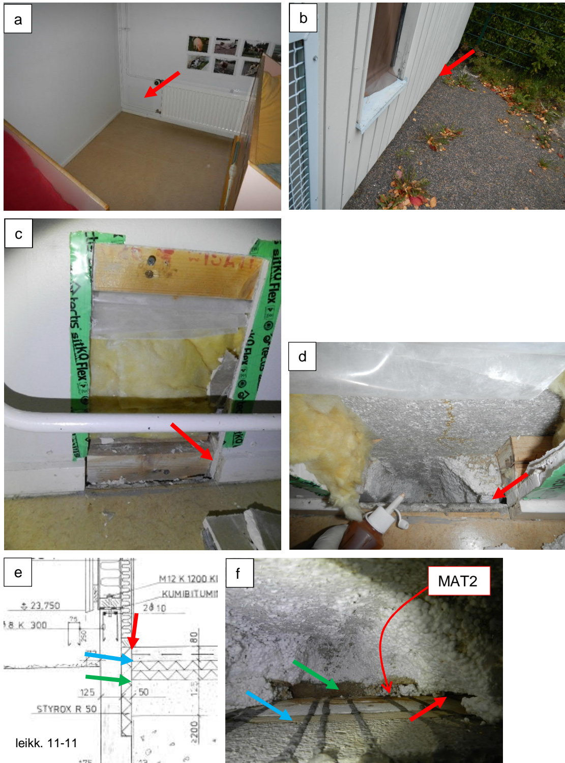
Kuva 15a-d. A: Rakenneavaus RAK5 sijaitsi tilassa 05 RH2. B: Rakenneavaus on kohdassa, jossa lattiapinta on matalimmillaan maanpintaan nähden (~250 mm). C: Ulko-seinän höyrynsulku on seinän alaosassa heti sisäverhouskipsilevyn takana. Muovin alareuna tiivistyy puukoolaukseen, mutta ei jatku lattiapinnan alapuolelle (kuva c, punainen nuoli). D-f: Alapohjabetonilaatan ja sokkelieristeen välissä on noin 10 mm:n rako (kuva d-f, punainen nuoli). Lattiavalun ja alapohjaeristeen välissä on valupaperi (kuva e ja f sininen nuoli). Eristeen pohja on lattiapinnasta n. 320 mm syvyydessä.
