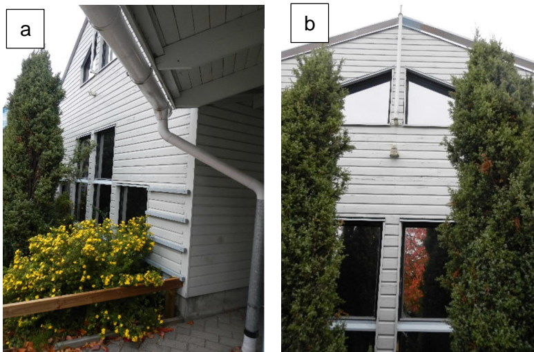
Kuva 7. Liikuntasalin päädyssä on runsaasti kasvillisuutta. Julkisivun maalipinta on jonkin verran rapistunut.
