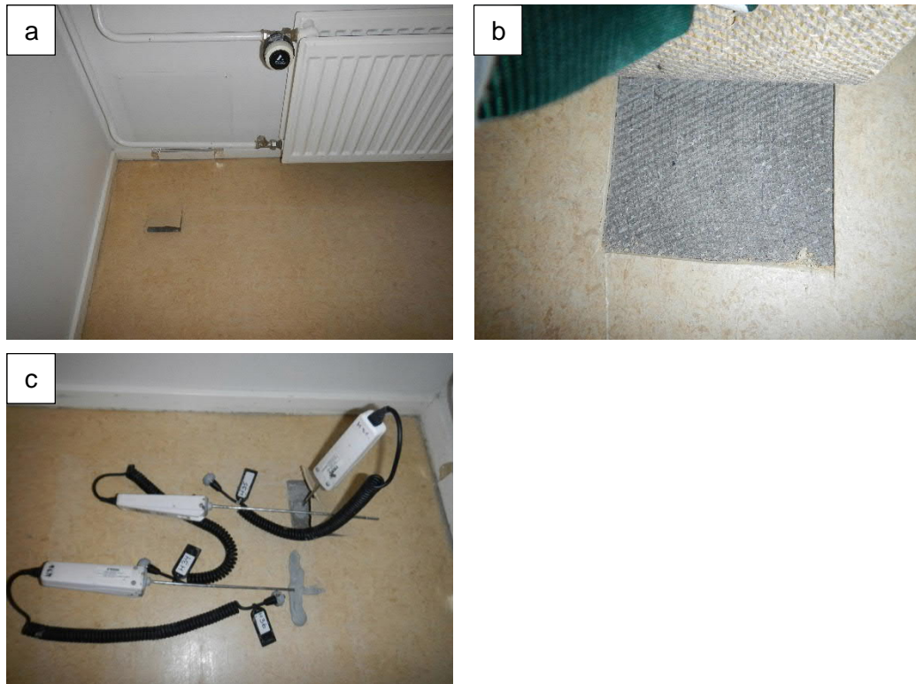
Kuvat 26a-c. Alapohjan kosteusmittaus tehtiin tilan 05 RH 2 ulkoseinän läheisyyteen. Maton alta ei havaittu tavanomaisesta poikkeavaa hajua. Matto oli tiukasti kiinni alus- tassaan.
