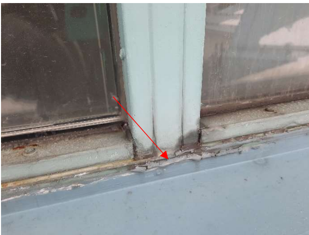
Kuva 85. Vesikaton rakenneliitosten tiivistysmassat ovat haurastuneet.
