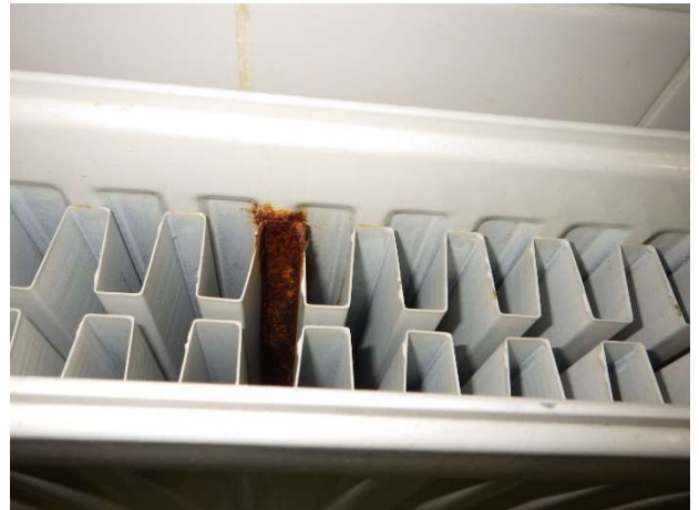
Kuva 34. Pyyhekuivaimen vuoto on aiheuttanut patteriin korroosiota.
