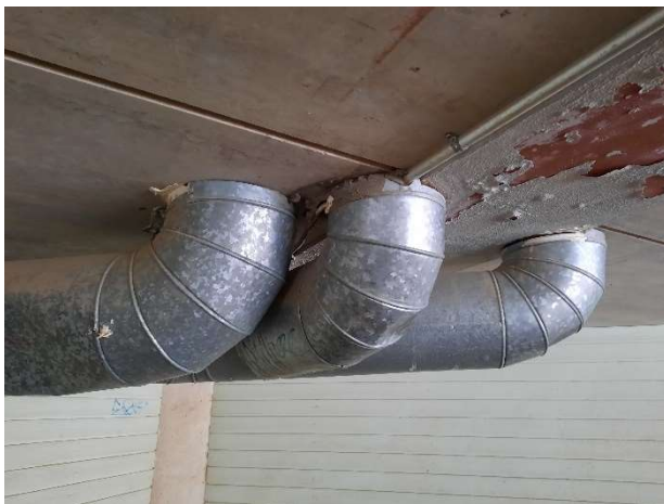
Kuva 13. Alapohjan viemärläpivientejä, joista todettiin ilmavuotoja sisätiloihin.
