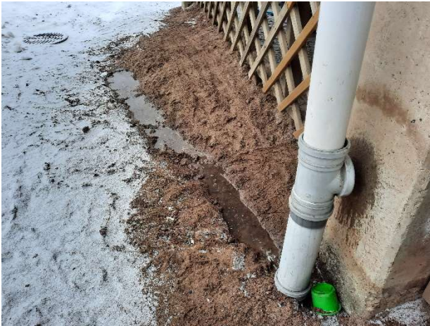
Kuva 89. Sadevedenohjauksessa on puutteita: syöksytorvi on todennäköisesti jäänyt ja haljennut.
