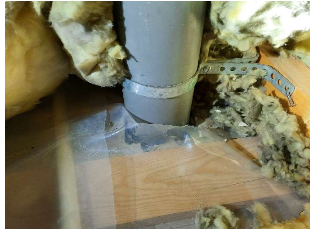
Kuva 88. Yläpohjan höyrynsulkua ei ole tiivistetty läpiveinneistä tai liitoksista.
