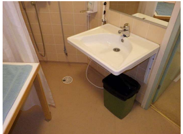
Kuva 38. Inva-WC Pesuallas. Altaan kiinnitykset ok.
