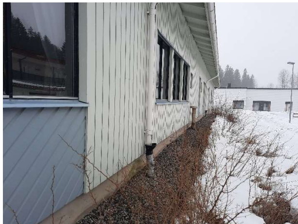
Kuva 3. Rakennuksen luoteissivu, jossa vierustalla leveä soratäyttö sekä pensasistutuksia. Istutuksien suositeltu etäisyys rakennuksesta on vähintään 3 m.
