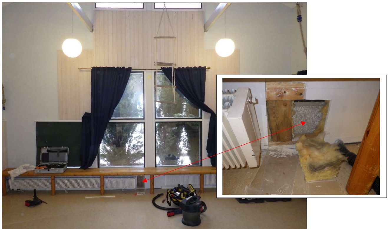
Kuva 48. Yleiskuva ja lähikuva tilan 26 (leikkisali) ulkoseinän rakenneavauksesta. Pienessä kuvassa mineraalivillassa näkyvä tummuma on peräisin todennäköisesti rakenteen ilmapuodosta. Pienessä kuvassa nuolen kärjen kohdalla näkyy sokkelin harmaa sisäpinta.
