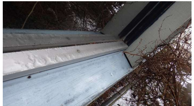
Kuva 56. Liikuntasalin ikkunoiden alaosat joutuvat melko kovalle kosteusrasitukselle.
