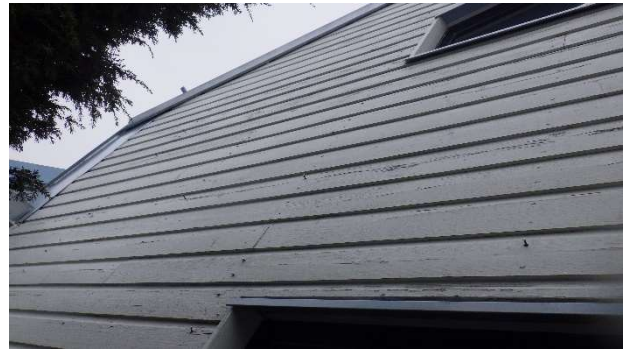
Kuva 58. Liikuntasalin päätyseinän osalla ei ole räystästä.
