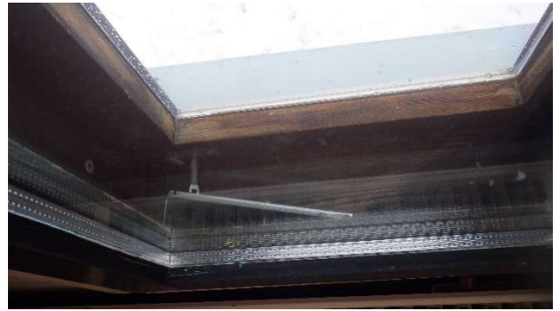
Kuva 52. Pääasiassa ikkunat sulkeutuivat hyvin vaikka kiinnityslaitteista puuttuikin osia.
