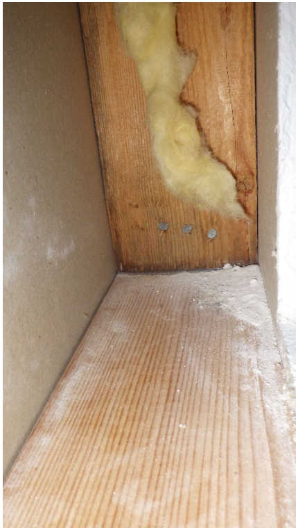
Kuva 64. Pystyrungon alaosassa merkkejä kosteudesta VSAV1.
