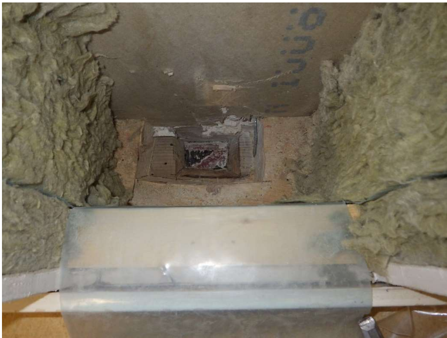
Kuva 47. Esimerkkikuva tilan 45 ulkoseinään tehdystä rakenneavauksesta (RA1). Alimmaisena kuvassa näkyy alemman alaohjauspuun ja bitumikermin alla oleva punainen metallirakenne.
