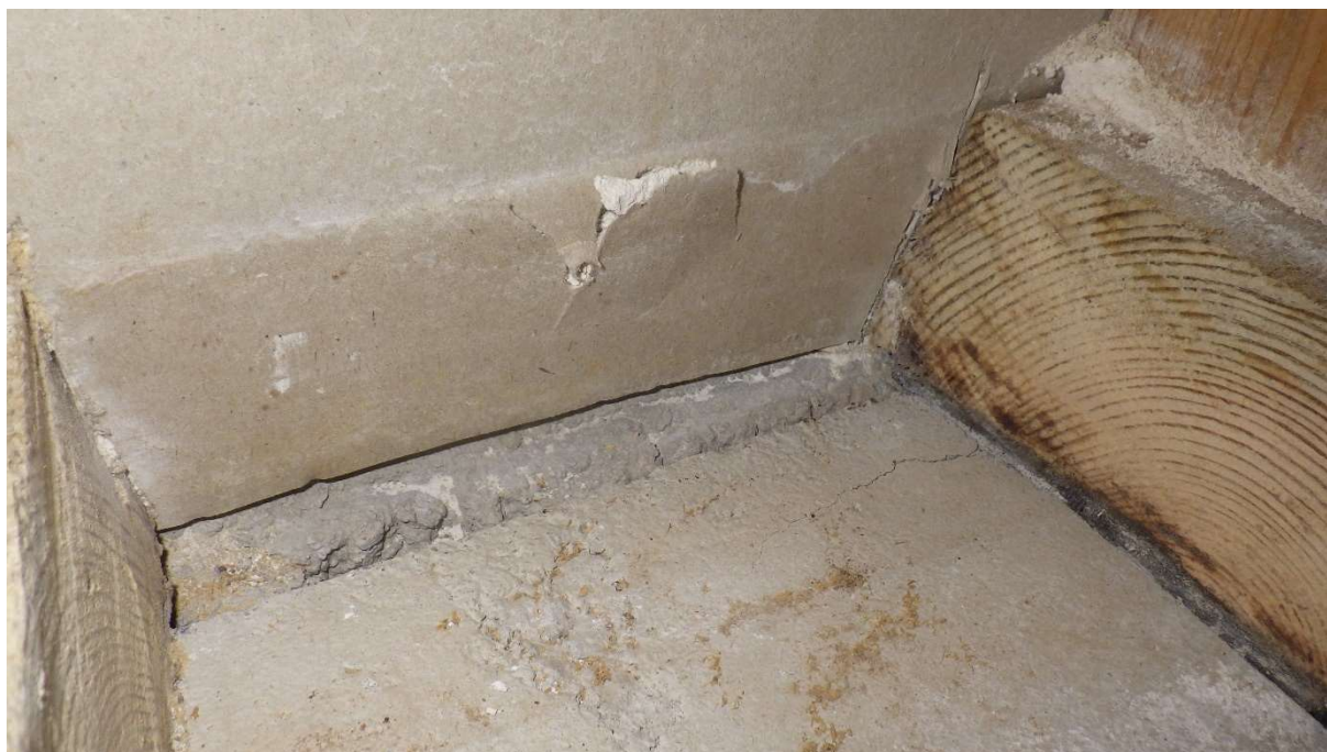
Kuva 70. VEO-huoneen puoleisen kipsilevyn taustapahvissa vähäisiä viitteitä mikrobikasvusta.
