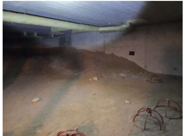
Kuva 10. Ryömintätilan maan pinta nousee rakennuksen keskiosaa lähestyttäessä.
