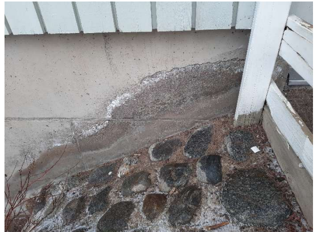
Kuva 6. Sokkelissa havaittuja kosteusjälkiä sisäpihan puolelta.
