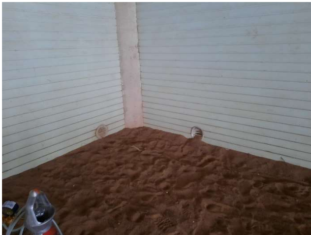
Kuva 11. Alustilan puurakenteiset seinät ovat kosketuksissa kapillaarisen täyttömaan kanssa.
