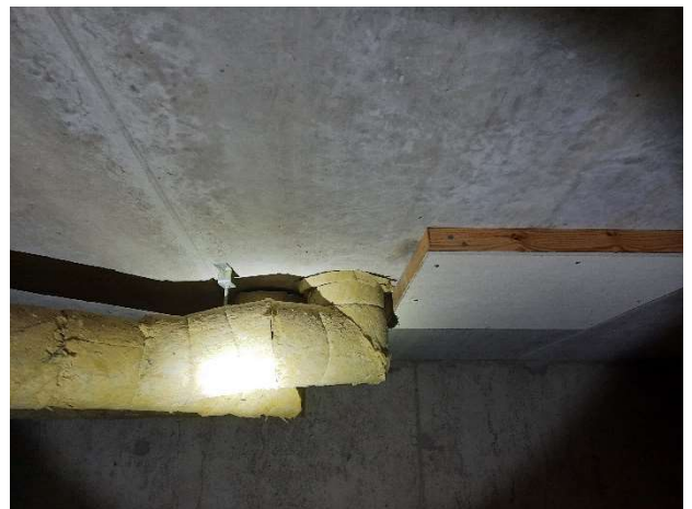
Kuva 14. Alapohjan viemärläpivientejä, joista todettiin ilmavuotoja sisätiloihin.
