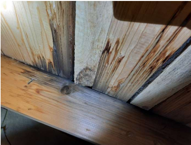
Kuva 87. Yläpohjan puurakenteissa oli kosteusvauriojälkiä rakenneliitosten kuten jiirien ja kattoikkunoiden läheisyydessä.
