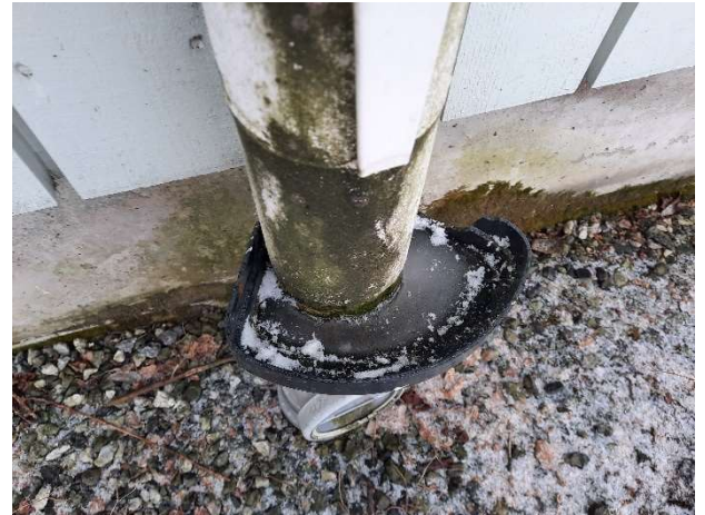
Kuva 90. Syöksytorvi on jäänyt ja haljennut.
