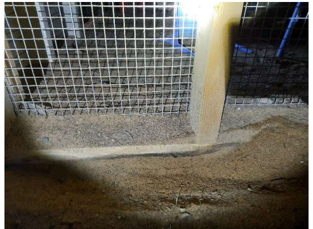
Kuva 12. Seinien alaosissa on havaittavissa kosteusvauriojälkiä.
