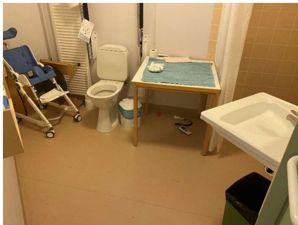
Kuva 20. Wc-tilan (21 WC/INVA) lattiassa havaittiin päällysteen alla ylimääräistä kosteutta viiltomittauksessa.
