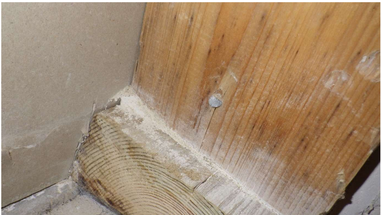
Kuva 69. Pystyrungossa viitteitä mikrobikasvusta.
