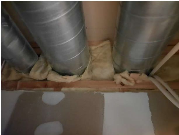
Kuva 76. Alakattorakenteiden sisällä havaittiin avoimia mineraalivillalähteitä (tila 47, eteishalli).
