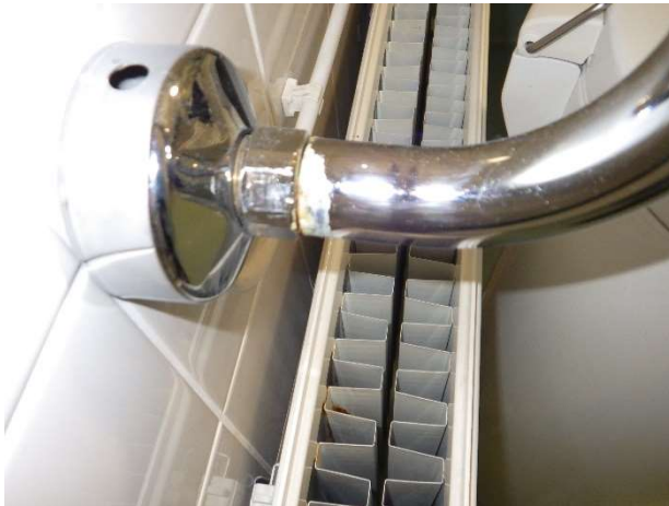
Kuva 35. Pienempi korroosiovaurio toisessa kuivaimessa.
