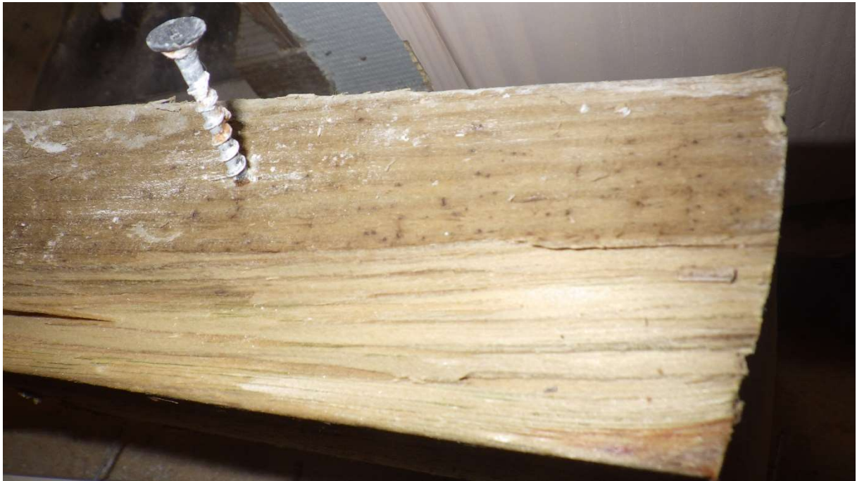
Kuva 68. Alaohjauspuun VEO huoneen puolella viitteitä mikrobikasvusta.
