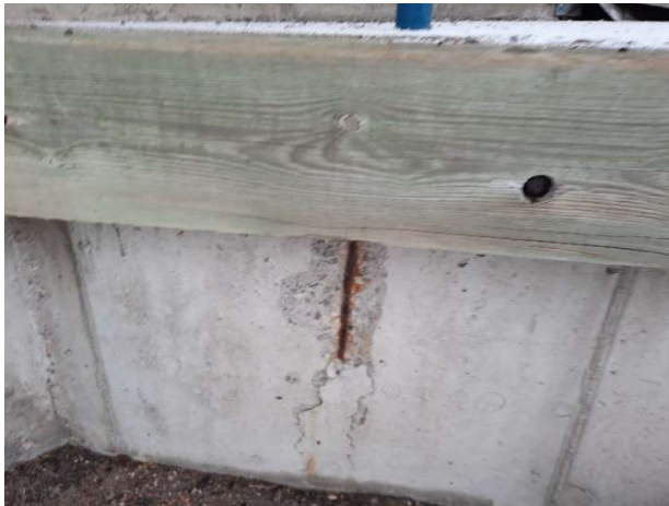
Kuva 5. Lastauslaiturin betonirakenteissa todettiin rapautumaa ja terästen korroosioaurioita.
