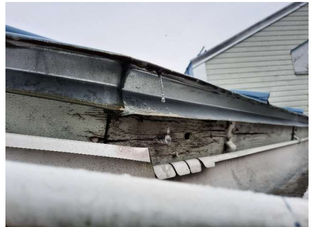
Kuva 84. Vuodot aiheuttavat vaurioita puurakenteille.
