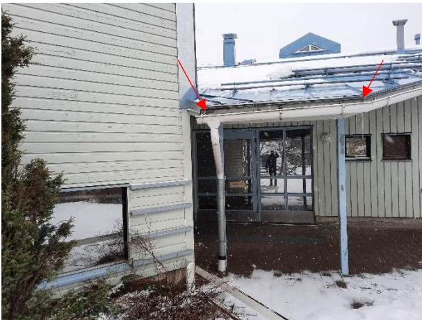
Kuva 83. Sisäpihan molemmissa sisäänkäyntilipoissa oli räystäällä vuotoja.
