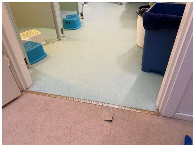
Kuva 24. Wc-tilojen ovien läheisyydessä lattiapäällysteen alle todennäköisesti on päässyt irtovettä kynnyksen liittymän kautta.
