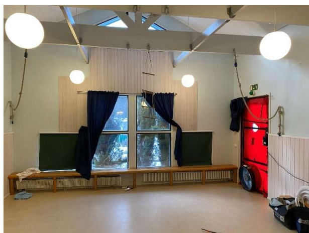
Kuva 23. Salin ulkoseinustalla havaittiin usean metrin matkalla lattiapäällysteen alla ylimääräistä kosteutta.
