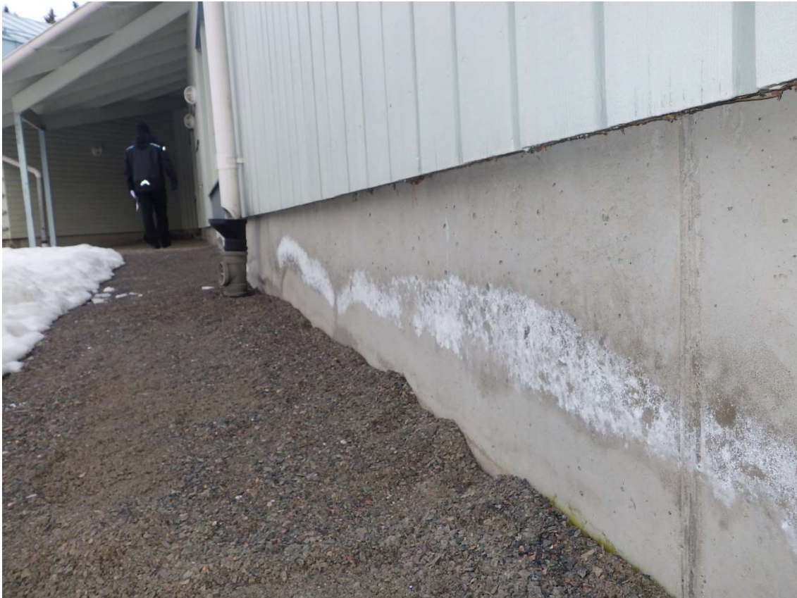
Kuva 45. Esimerkkikuva sokkelin ulkopinnassa havaituista kosteusjäljistä.
