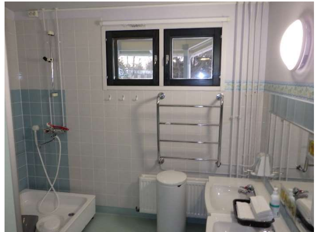
Kuva 30. Pyyhekuivaimissa havaittiin muutamia korroosioaurioita.
