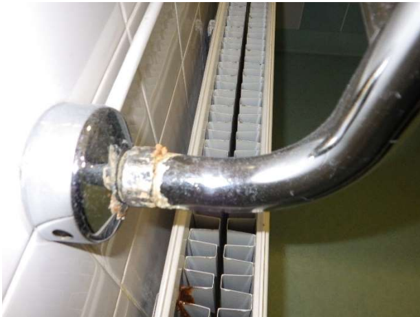
Kuva 33. Pyyhekuivaimen koroosioaurio ja tihkuvuoto.
