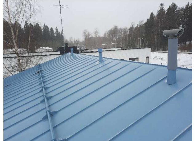
Kuva 82. Vesikatteen pinnoite on arviolta uusittu rakennuksen elinkaaren aikana.
