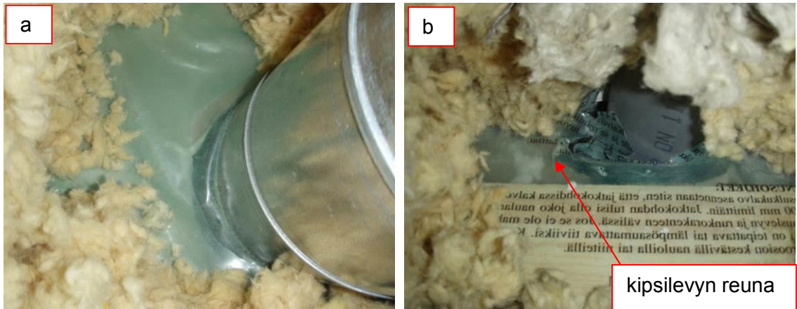
Kuva 52. Poistopuhaltimen höyrynsulkuläpivienti on tiivis (kuva a). Viemärin tuuletusputkien läpiviennit ovat epätiivit. Myös höyrynsulun alapuolella oleva kipsilevy on epätiivis (kuva b). Viemärin tuuletusputkien kohdalla ei havaittu vaurioita, jotka johtuisivat kostean sisäilman liiallisesta kulkeutumisesta yläpohjaan.
