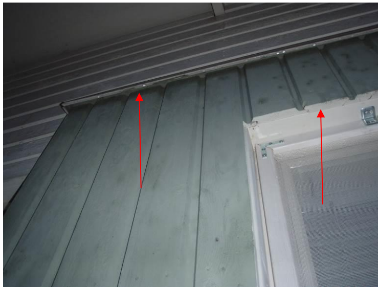
Kuva 25. Ikkunaliittymissä ja julkisivupellityksen liittymissä ulkoseinän ilmaväli ei ole avoin ulkoilmaan.
