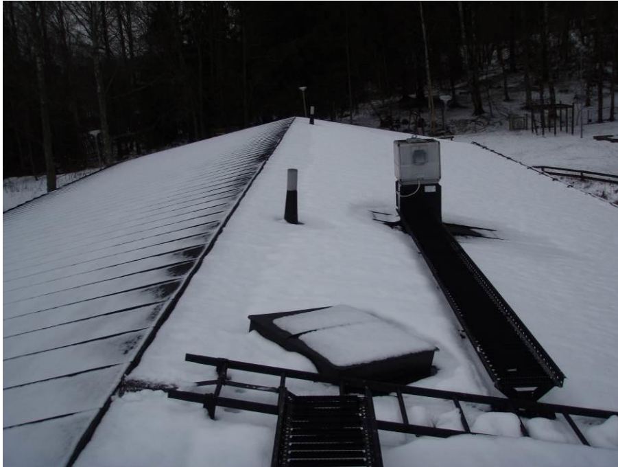
Kuva 41. Vesikatto oli lumipeitteinen. Katolla ei havaittu lumen sulakohtia, jotka viittaisivat merkittävään lämpövuotoon.
