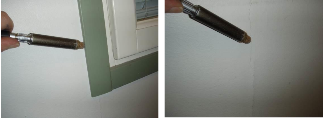
Kuva 28. Ilmavuotoa havaittiin ikkunaliittymissä ja kipsilevytyksen halkeamassa
