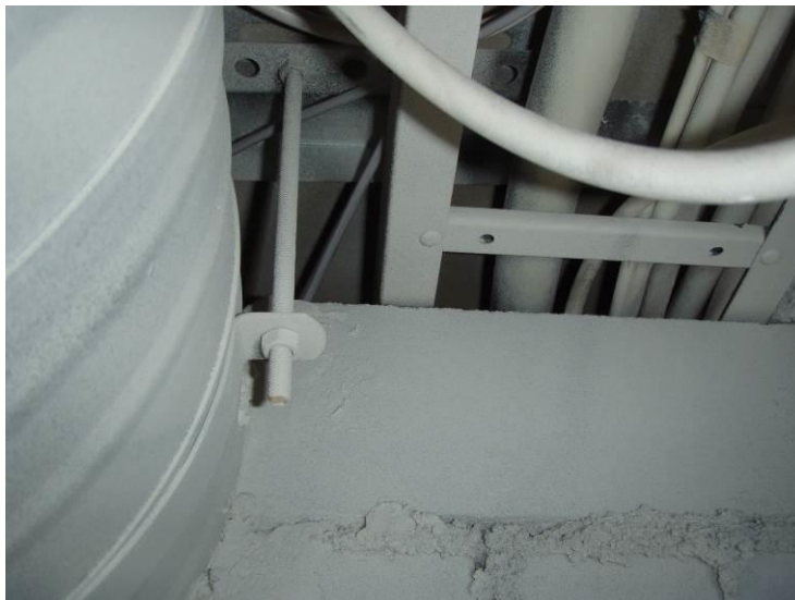
Kuva 38. Sähköläpiviennin harkkoseinässä on avoin.
