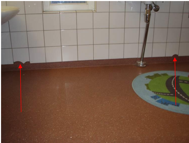
Kuva 21. Lasten wc-tiloissa keraamisen laatoituksen alareunat ovat paikoin rikki. Muutama alareunan laatta on haljennut. Alapohjan muovimatto ulottuu laatoituksen taakse ja rikkoutuneiden kohtien yläpuolelle
