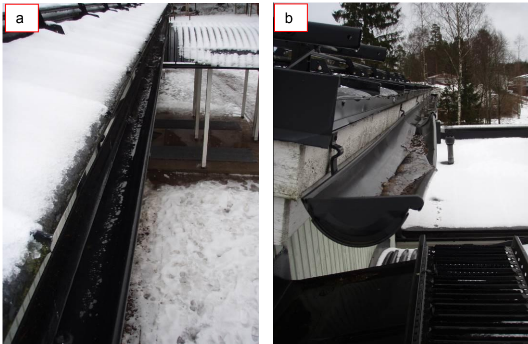
Kuva 45. Rästaskouruissa oli vettä, vaikka tarkastelukohdalla ei havaittu merkittäviä määriä roskaa (kuva a). Paikoin räystäskourujen ulkoreunat ovat painuneet ja vesi tulvii painuneesta kohdasta yli (kuva b).
