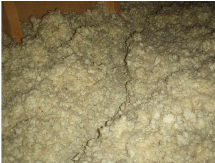
Kuva 53. Yläpohjan puhallusvillassa on eläinten tekemiä polkuja. Eläimet pääsevät yläpohjaan räystäiden kautta, koska räystäillä ei ole eläinverkkoja.
