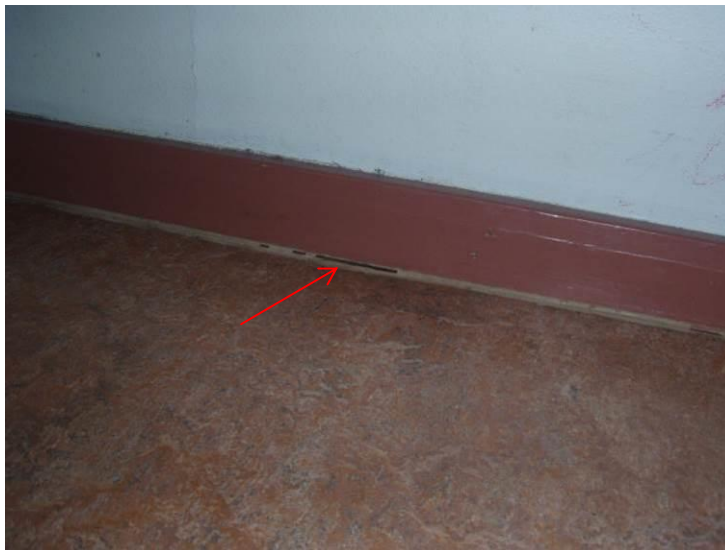
Kuva 4. Ryhmähuoneessa (huone 5) alapohjan ja jalkalistan välissä on rako. Alapohjassa ei havaittu vastaavaa kohoumaa tai lattiapäällysteen kuprua kuin päiväkodin johtajan huoneessa ja nukkumahuoneessa (ks. edellinen kuva). Merkkisavulla kohdassa ei havaittu ilmavuotoa.
