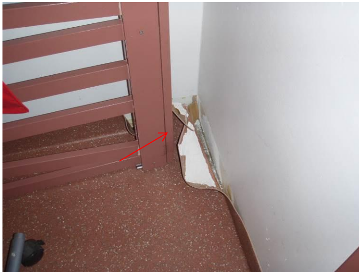
Kuva 6. Henkilökunnan pukuhuoneessa käytävän vastaisessa nurkassa muovimatton ylösnosto on irti. Pintakosteusilmaisimen lukemat alapohjalla oli 70...82 (muovimatto) ja suihkutilan vastaisella harkkoseinällä muovimatton ylösnoston korkeudella 55 ja ylempänä 49. Käytävän vastaisella kipsilevyseinällä vastaavat lukemat olivat 39 ja 22. Seinäpinnoilla ei havaittu kosteusvaurioon viittaavia merkkejä.
