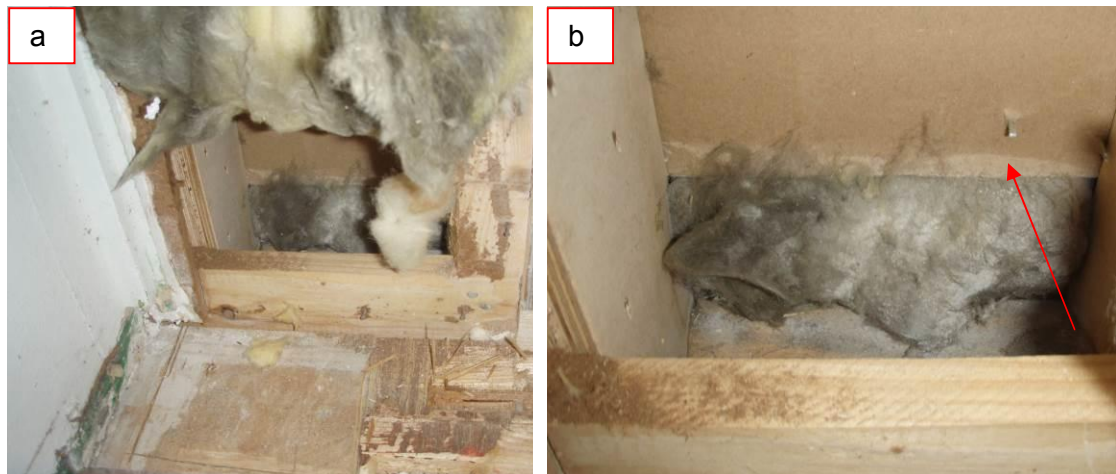
Kuva 40. Vanhan ulkoseinärakenteen mineraalivilla on tummunut johtuen todennäköisesti ennen uuden puolen rakentamista rakenteeseen kulkeutuneesta ulkoilmapölystä ja vanhan puolen ryömintätilasta kulkeutuneesta pölystä (kuva a). Mineraalivillasta otetussa näytteessä ei ollut poikkeavaa mikrobikasvua. Uuden puolen kipsilevyn alareunassa on jälki, joka johtuu todennäköisesti levyn alareunan kastumisesta uuden puolen alapohjan betonilaatan valun aikana (kuva b). Alkuperäisen ulkoseinärakenteen alaohjauspuu ja pystyrunko ulottuvat lattiapinnan alapuolelle.
