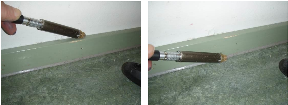
Kuva 29. Ilmavuotoa havaittiin ulkoseinä-alapohjaliittymässä.
