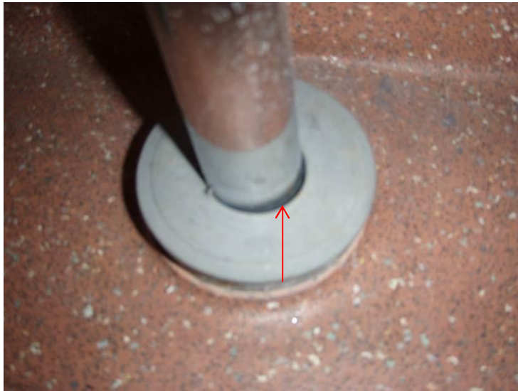
Kuva 7. Henkilökunnan wc-tilan ja pukuhuoneen pesualtaiden viemärien läpivienttiivistykset ovat epätiivit.
