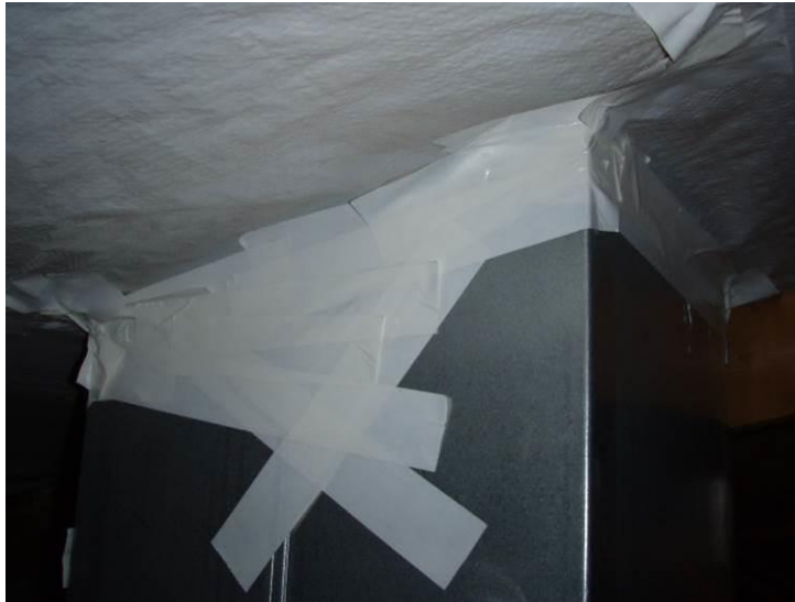
Kuva 50. Poistopuhaltimen aluskateliittymä on korjattu liitosnauhoilla. Aiemmassa tutkimuksessa liittymä oli todettu epätiiviksi.
