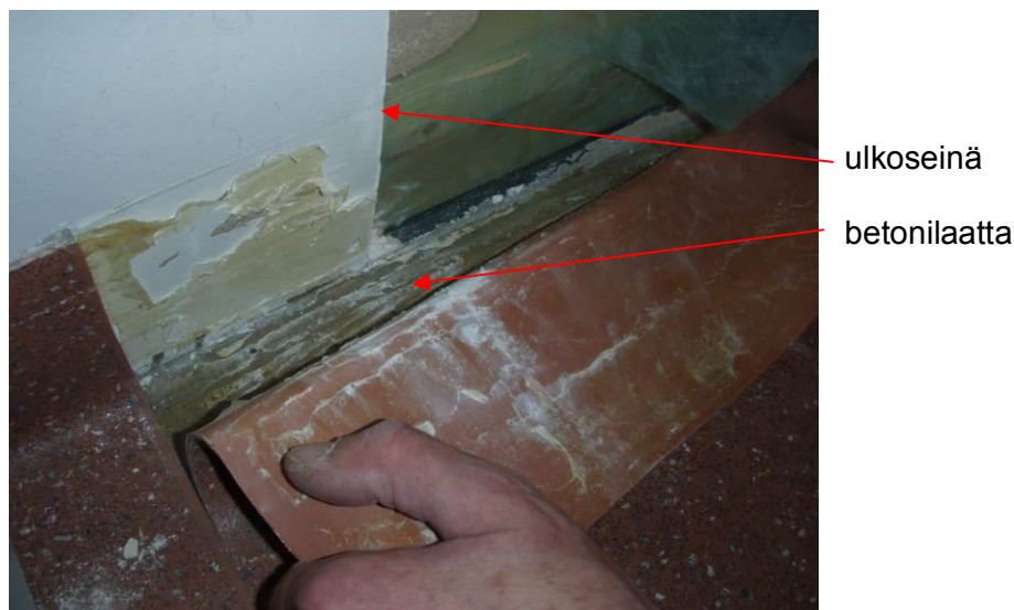
Kuva 19. Rakenneavauskohdassa RAK6 alapohjassa ei ole kohoumaa eikä halkeamaa ulkoseinän vieressä.
