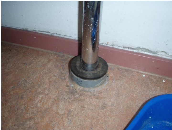
Kuva 35. Huoneen 5 pesualtaan alapuolella väliseinän pinnoite on halki. Pintakosteusilmaisimen lukema vauriokohdalla oli 25...30 ja muualla 27.
