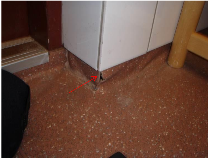
Kuva 5. Vanhan puolen viereisessä "Eskareiden" kuraeteisessä muovimatton ylösnosto on irti alustastaan ja saumassa on rako.
