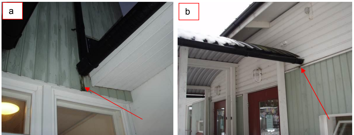
Kuva 27. Pääsisäänkäynnin seinustalla vanhan puolen vesikaton räystäskourun pääty vuotaa julkisivulle (kuva b). Pihan puolella sisäänkäyntikatoksen räystäskouru vuotaa julkisivulle (kuva b).
