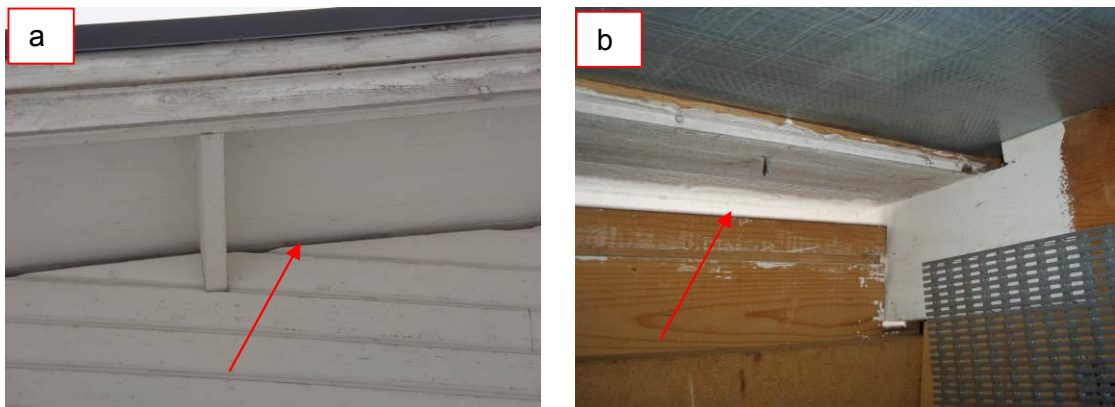
Kuva 44. Yläpohjan ilmatila tuulettuu räystäiden kautta. Tuuletusvälit ovat avoimet, mutta niistä puuttuu eläinverkot.
